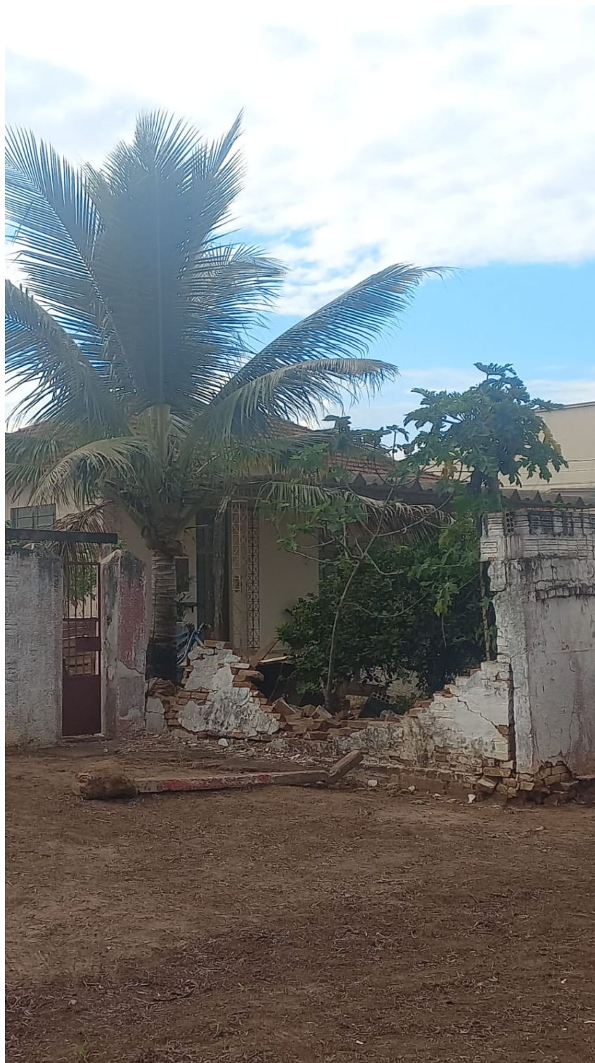
Muro dos fundos do velório
