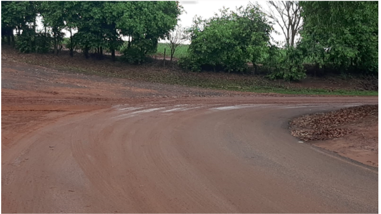
Avenida Henrique Cândido de Oliveira – acesso a Estrada Municipal José Dias da Silveira do Distrito de Turvínea
