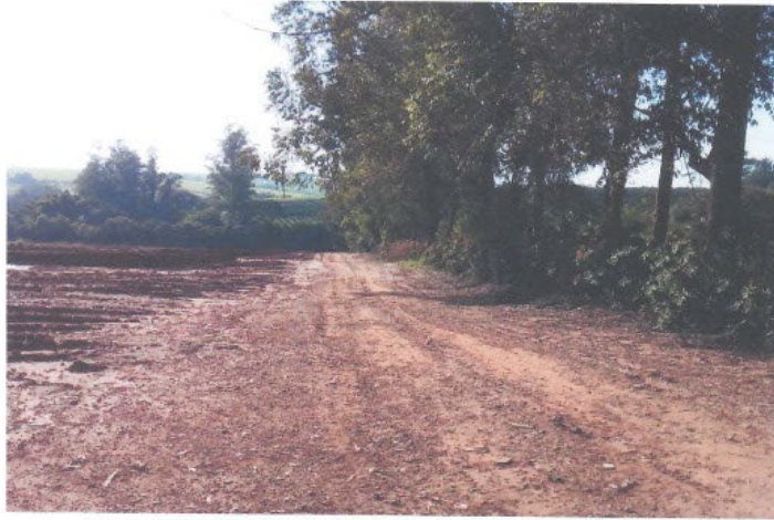
Foto 11 – Detalhe – Vista da Estrada Municipal BBD – 475 do Município de Bebedouro/SP. Foto 12 – Detalhe – Vista da Estrada Municipal BBD - 475 do Município de Bebedouro/SP.
