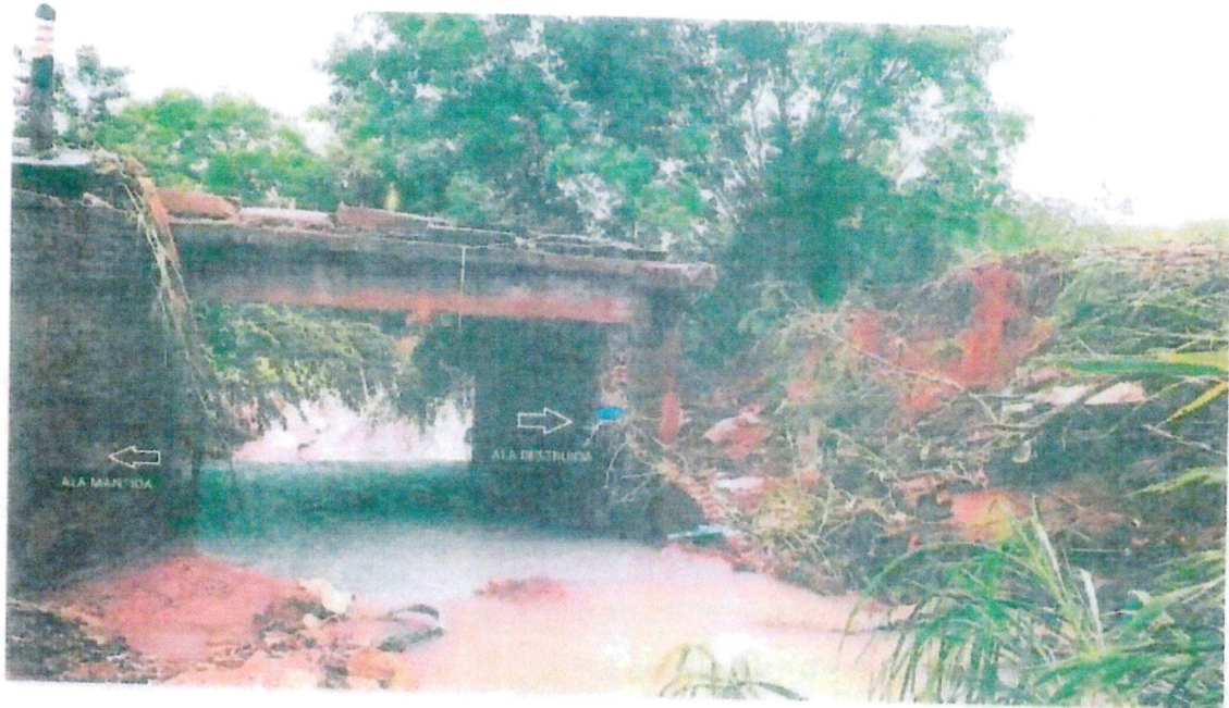
FOTO 1 : Vista Longitudinal da ponte com sua ALA direita destruída.
