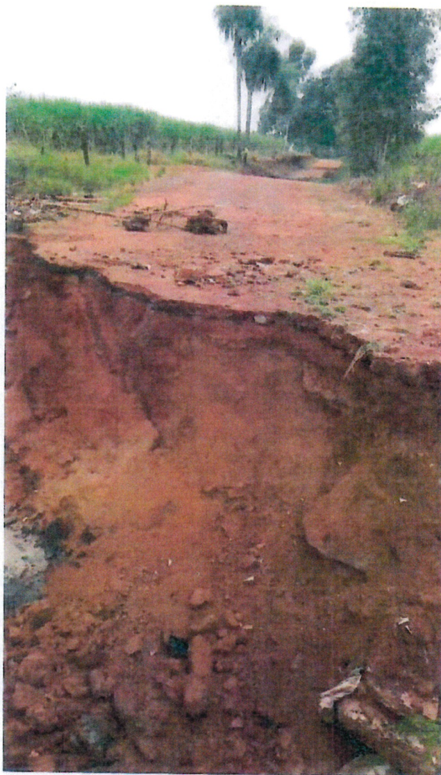
Imagem 2: Erosão provocado pelas águas da chuva – 23/01/2020.
