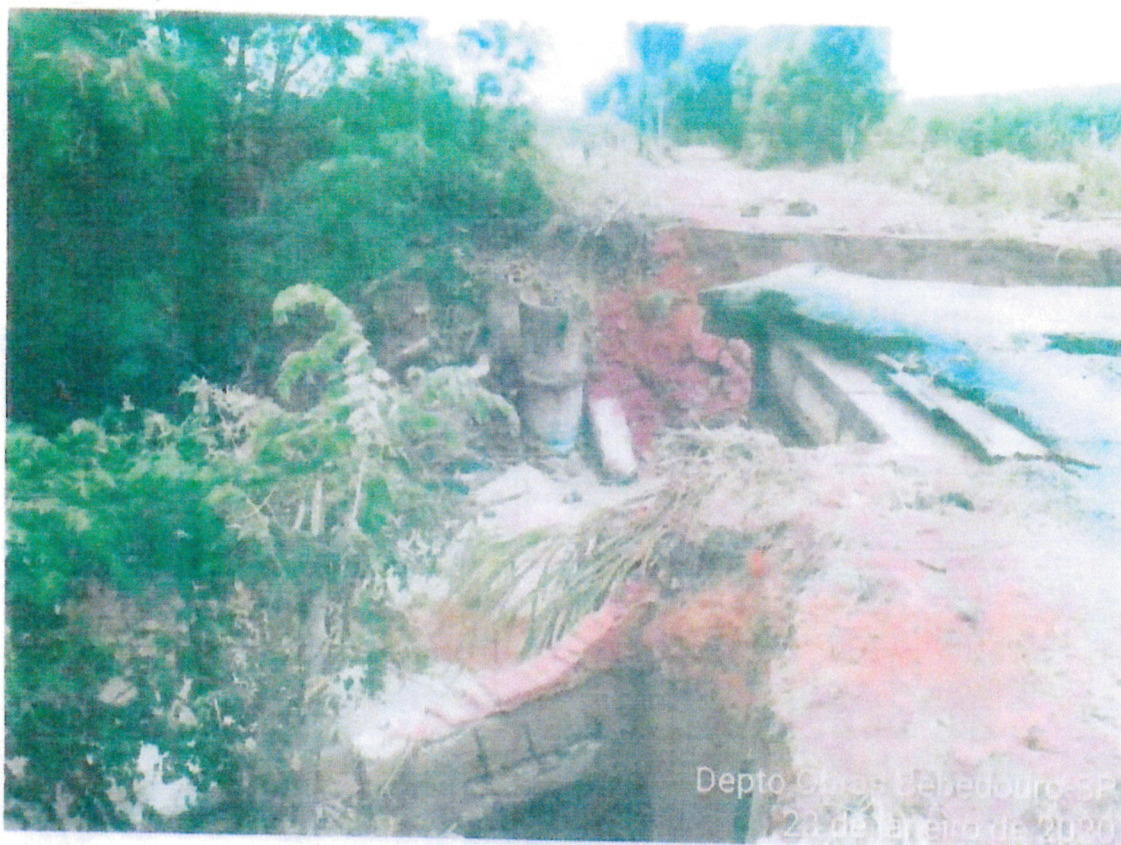
FOTO 3: Vista das Alas esquerdas destruídas
