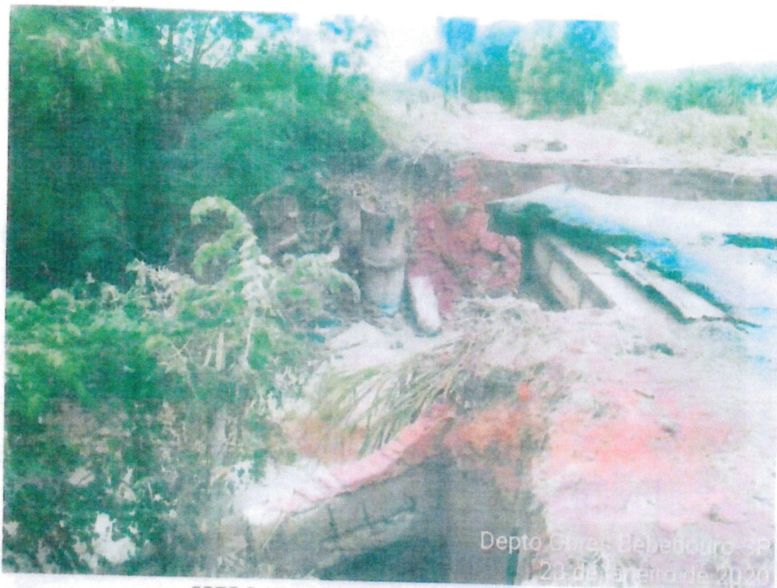
FOTO 3: Vista das Alas esquerdas destruídas
