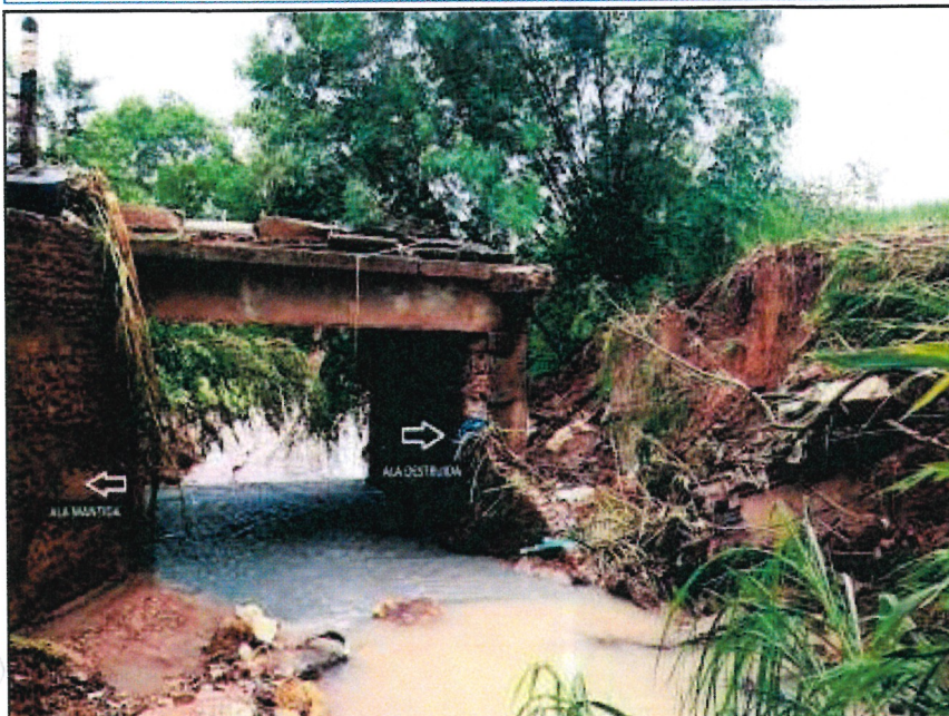
Ponte de Acesso ao Reage Brasil (colapsada)
