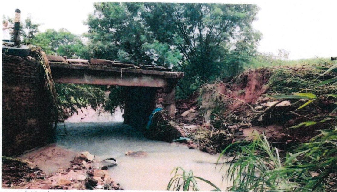
Imagem 1: Vista lateral da ponte - Data 23/01/2020 (sem atender a IN 02/2016, art. 8º, § 1º, c.)
