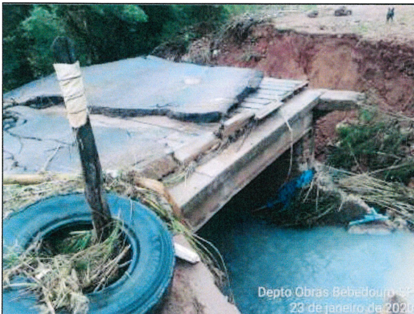
Ponte de Acesso ao Reage Brasil (colapsada)
