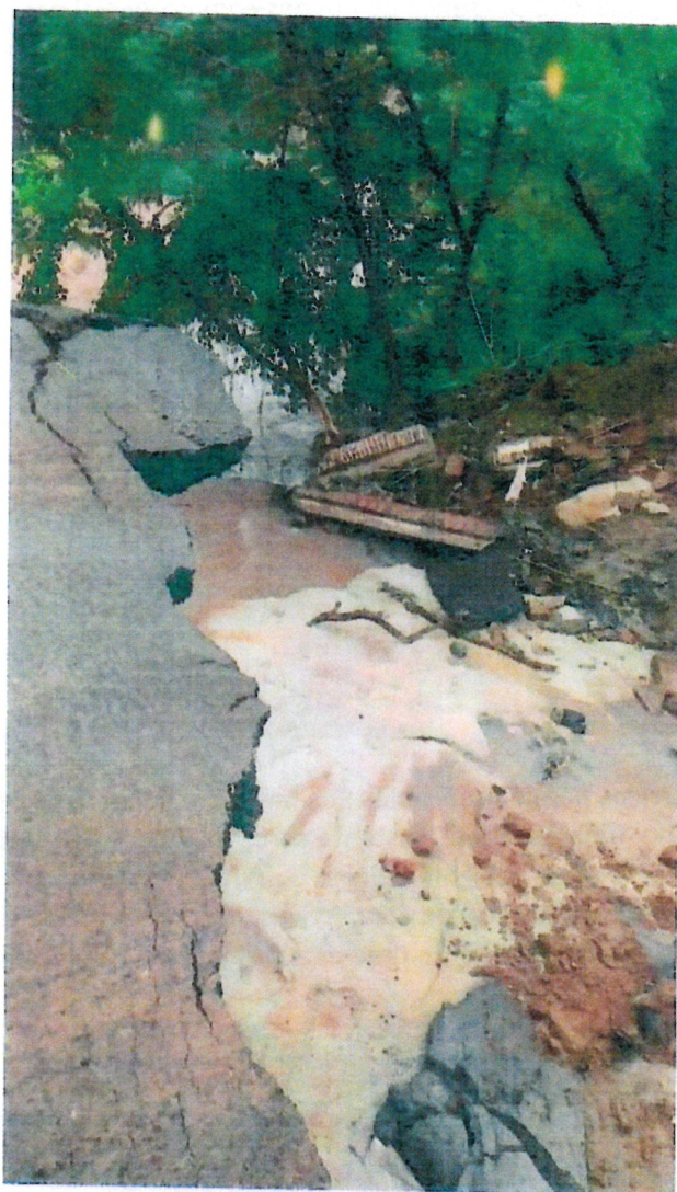
Imagem 4: Parte da pavimentação danificada
