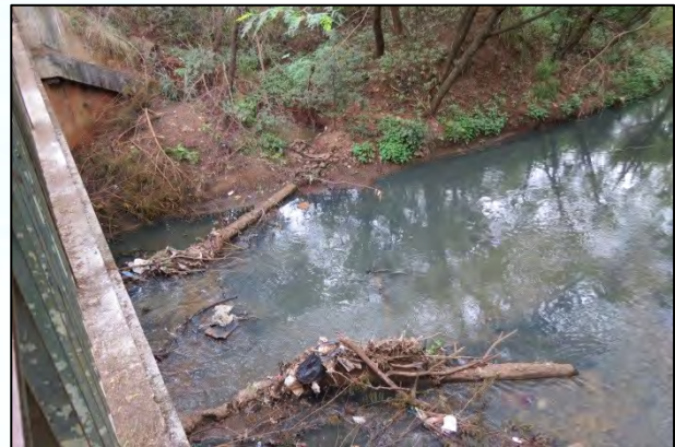
Foto 36. Registro das estruturas da antiga ponte que, devido suas dimensões, obstruía o escoamento as águas e potencializavam as inundações. A nova ponte foi financiada pela Coordenadoria Estadual de Defesa Civil do estado de São Paulo.
