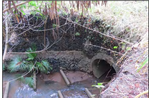
FOTO 10. Vista de tubulação, localizada na margem esquerda do córrego Bebedouro e próxima à ponte mostrada na FOTO 8 , e dispositivos para dissipação de energia. Notar aspectos das obras de contenção (muros de gabião).
