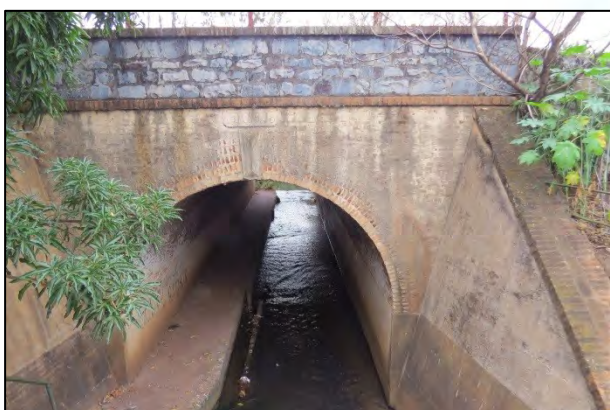
FOTO 23. Aspecto de travessia do córrego Bebedouro. Trata-se de galeria construída no ano de 1928.
