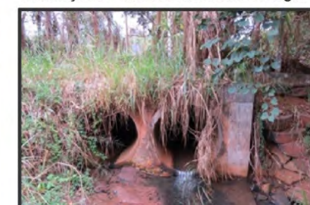
Registro de tubulação que despeja água no córrego mostrado na FOTO 26. Notar dimensões e fragilidade das contenções na lateral esquerda (pneus justapostos).
