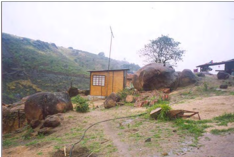
Figura 12 – Situação de risco de rolamento de bloco rochoso (Ministério das Cidades, Instituto de Pesquisas Tecnológicas do Estado de São Paulo – IPT, 2007).
