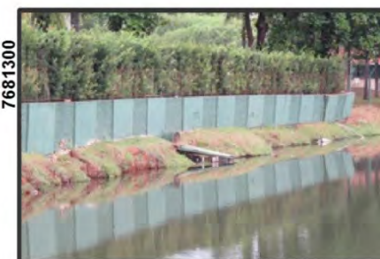
Registro de pequenas rupturas dos taludes marginais (muro lateral mostrado na FOTO 15). Segundo informações da Compdec as ocorrências podem estar associadas a variação de cota da água do lago.
