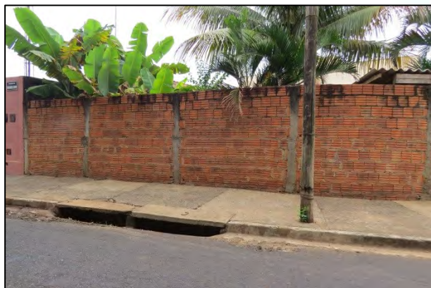
Foto 39. Vista de "bocas de lobo" (sem gradil) responsáveis pela coleta das águas que escoam nas vias de acesso (Avenida Dr. Antônio Honório da Fonseca e Castro Neto). Segundo informações locais, esse sistema pode funcionar como condutores das águas do córrego por meio de tubulações que se encontram no canal (refluxo – ver FOTO 40 ).
