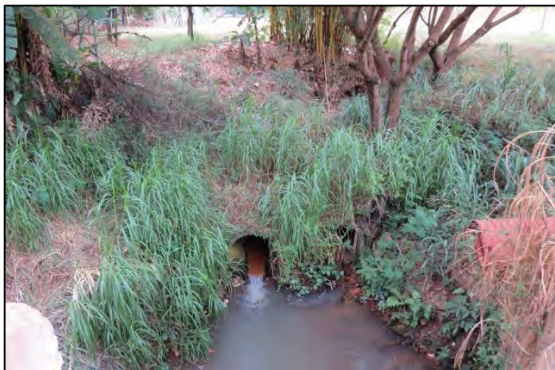
FOTO 5. Vista do final do trecho do córrego Vidal canalizado sob a travessia. Notar a grade derrubada quando da inundação do córrego datada de 31/01/2017 e o solapamento indicado pela seta vermelha.
