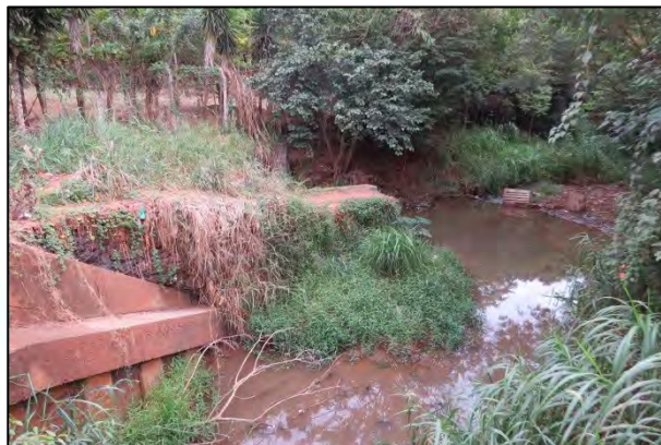
FOTO 26. Vista, de montante para jusante, do córrego natural e que se encontra assoreado. Notar lâmina d'água e vegetação no entorno da área.
