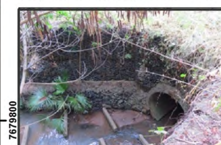
Vista de tubulação, localizada na margem esquerda do córrego Bebedouro e próxima à ponte mostrada na FOTO 8, e dispositivos para dissipação de energia.
