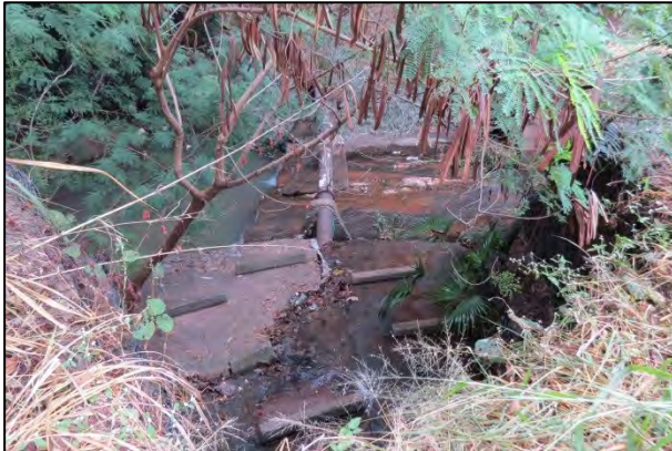
FOTO 9. Registro da tubulação de água que cruza transversalmente o córrego Bebedouro. Notar, em primeiro plano, dispositivos para dissipação de energia das águas providas de tubulação lateral ao eixo da drenagem (ver FOTO 10 ).
