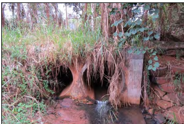
FOTO 27. Registro de tubulação que despeja água no córrego mostrado na FOTO 26 . Notar dimensões e fragilidade das contenções na lateral esquerda (pneus justapostos).
