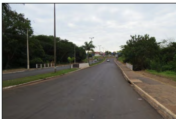
FOTO 24. Vista geral da Avenida Prefeito Edne José Piffer, nas proximidades do encontro do córrego Bebedouro com o ribeirão Consulta. Segundo dados e histórico da Compdec, a avenida é afetada pela inundação das drenagens.
