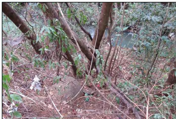
Foto 40. Registro de tubulação localizada na margem direita do córrego Bebedouro. Esses sistemas, devido às cheias da drenagem, podem conduzir as águas para as vias de circulação de pessoas e veículos.
