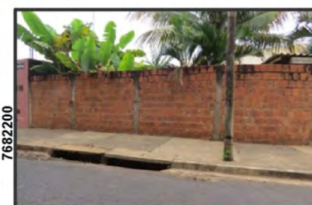
Vista de "bocas de lobo" (sem gradil) responsáveis pela coleta das águas que escoam nas vias de acesso (Avenida Dr. Antônio Honorio da Fonseca e Castro Neto).
