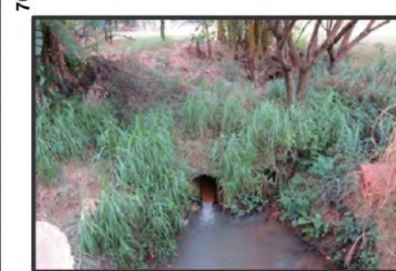
Vista do final do trecho do córrego Vidal canalizado sob a travessia. Notar a grade derrubada quando da inundação do córrego datada de 31/01/2017 e o solapamento indicado pela seta vermelha
