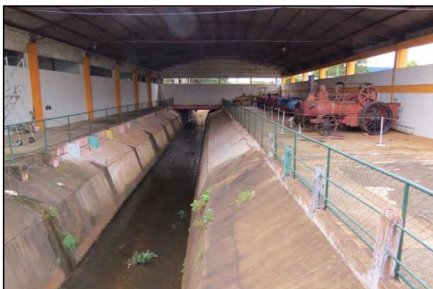
FOTO 21. Vista do córrego Bebedouro canalizado em seção trapezoidal. Trata-se de trecho localizado no terreno do Museu "Eduardo André Matarazzo" (parede a esquerda da imagem): notar veículos localizados na margem direita.
