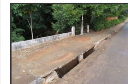
Vista do muro derrubado quando da inundação do córrego Vidal datada de 31/01/2017.
