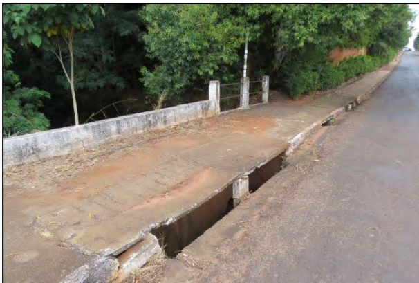
FOTO 3. Vista do muro derrubado quando da inundação do córrego Vidal datada de 31/01/2017.
