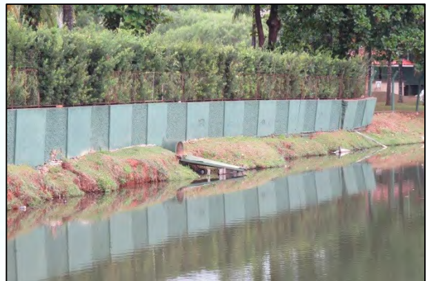
FOTO 16. Registro de pequenas rupturas dos taludes marginais (muro lateral mostrado na FOTO 15). Segundo informações da Compdec as ocorrências podem estar associadas a variação de cota da água do lago.
