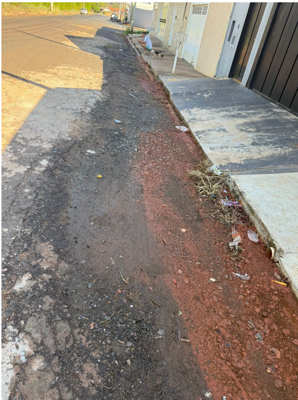
AVENIDA JOSÉ MÁRIO FERREIRA LIMA, PRÓXIMO AO Nº 175 – PARATI III
