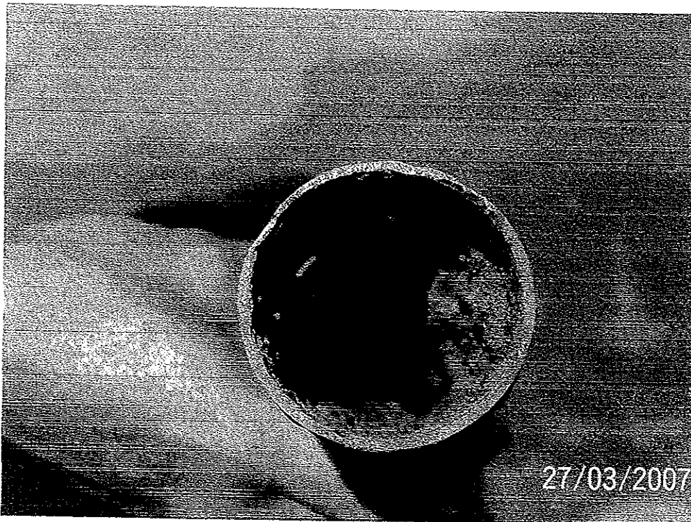
FOTO - 02 - TUBULAÇÃO TODA INCUSTRADA, IMPEDINDO PASSAGEM DA ÁGUA.
