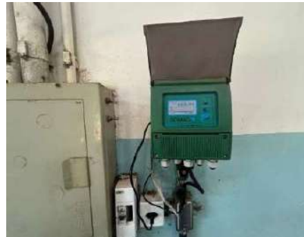
Figura 4-28 Vista display macromedidor de vazão
