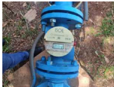
Figura 4-142 Macromedidor do poço Elizabeth
