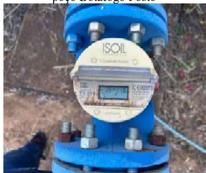
Figura 4-150 Vista do macromedidor do poço Botafogo Posto
