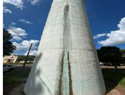
Figura 4-170 Vista do vazamento externo do reservatório de Andes
