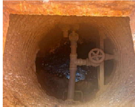
Figura 4-114 Vista do vazamento
