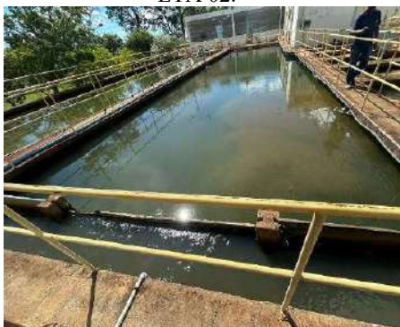
Figura 4-97 Vista do decantador 01 da ETA 02.
