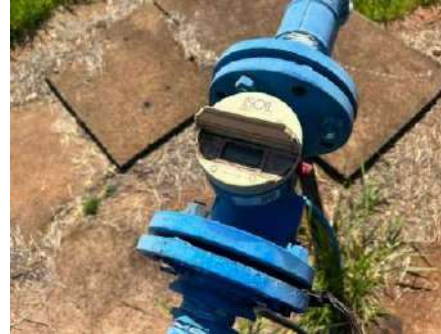
Figura 4-290 Vista do macromedidor de vazão do poço Julia Velho
