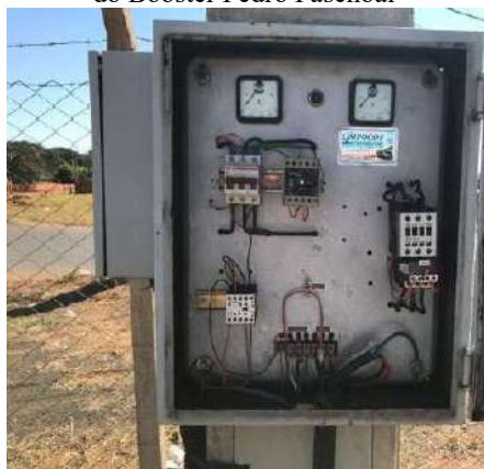
Figura 4-432 Vista interna painel elétrico do Booster Pedro Paschoal
