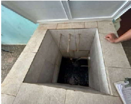
Figura 4-103 Vista elevada da saída da água filtrada com dosagem de cloro, flúor e ortopoli
