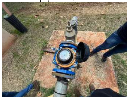
Figura 4-140 Vista do medidor de vazão do poço ETA 02 Novo
