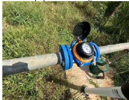
Figura 4-198 Vista do medidor de vazão do poço Portal do Lago 02
