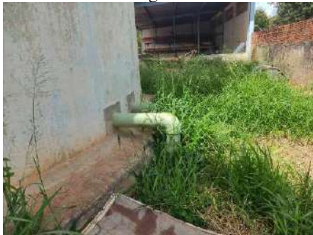
Figura 4-255 Tubulação de saída localizada na parte traseira do reservatório Progresso Alto/Baixo
