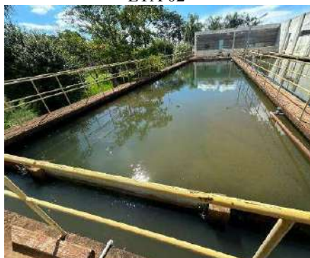
Figura 4-98 Vista do decantador 02 da ETA 02
