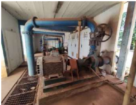
Figura 4-117 Vista dos conjuntos motor-bomba da ETA 02
