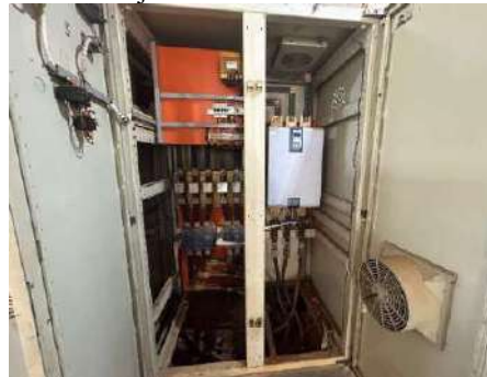
Figura 4-44 Vista painel elétrico dos conjunto motor-bomba 01
