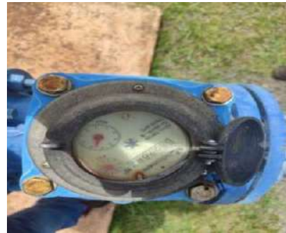
Figura 4-326 Macromedidor do poço SetJardim
