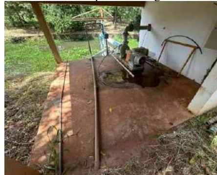
Figura 4-16 Vista Conjunto motor-bomba de recalque do córrego
