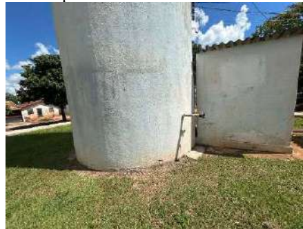
Figura 4-190 Vista da tubulação de limpeza do reservatório Turvânia
