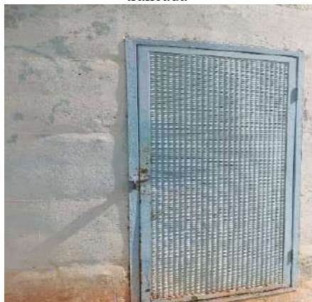
Figura 4-360 Porta de acesso que estava trancada
