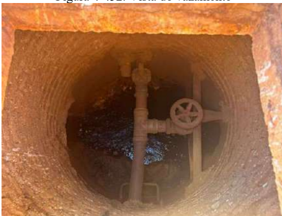
Figura 4-452. Vista do vazamento
