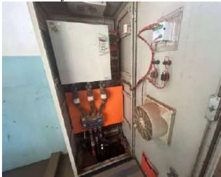
Figura 4-23 Vista painel elétrico do conjunto motor-bomba 01
