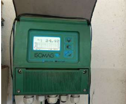
Figura 4-259 Vista display macromedidor de vazão
