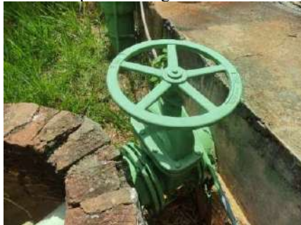
Figura 4-267 Vista da tubulação de manobra para descarga do Reservatório
