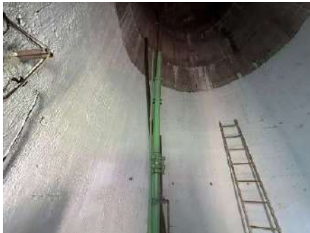
Figura 4-189 Vista superior da tubulação de entrada e saída do reservatório Turvânia
