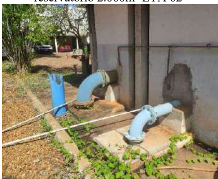
Figura 4-123 Tubulação de saída do reservatório 2.000m 3 ETA 02
