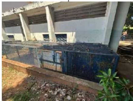
Figura 4-38 Vista frontal dos poços de sucção
