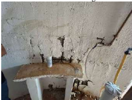
Figura 4-155 Armadura exposta do reservatório Botafogo
