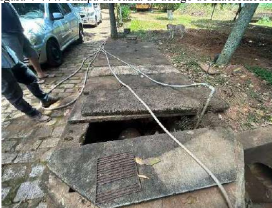
Figura 4-444. Tapa da caixa de abrigo do macromedidor
