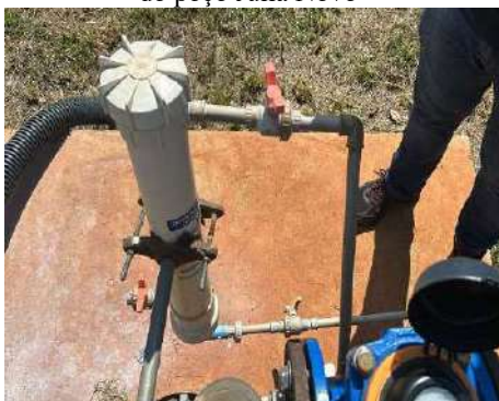
Figura 4-301 Vista sistema de tratamento do poço Julia Novo
