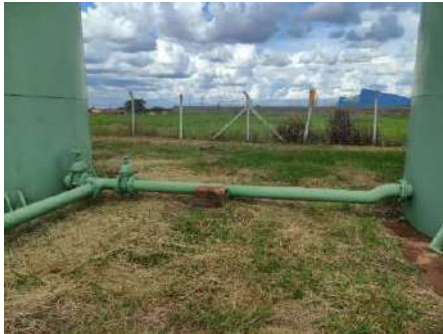
Figura 4-417 Vista das ligações entre os reservatórios
