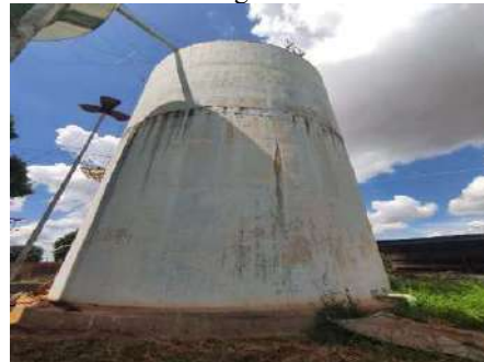
Figura 4-256 Vista de uma rachadura no reservatório e tubo vaso comunicante do reservatório Progresso Alto/Baixo
