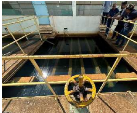
Figura 4-100 Vista do filtro 02 da ETA 02
