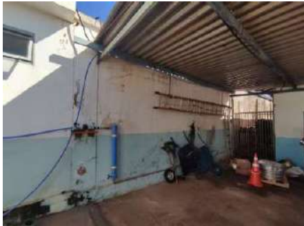
Figura 4-81 Vista lateral do reservatório Almoarifado ETA 01
