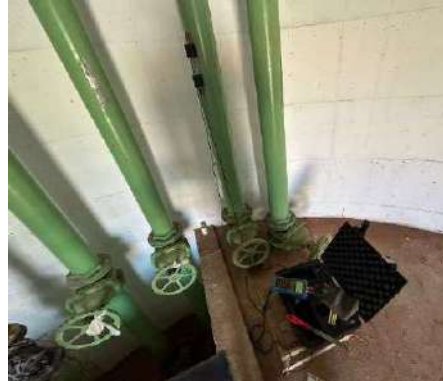
Figura 3-59. Medição de Vazão – Reservatório Baixo Boa Vista.
