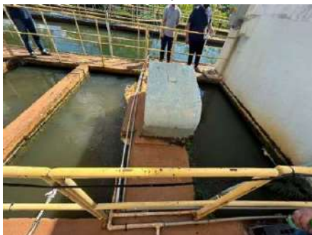
Figura 4-93. Vista do floculador 01 da ETA 02
