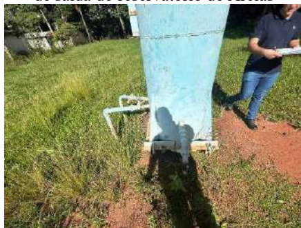
Figura 4-182 Vista das duas tubulações de saída do reservatório de Areias
