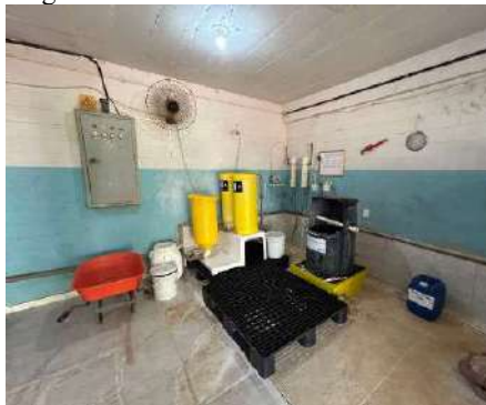
Figura 4-108 Vista das colunas de cloro
