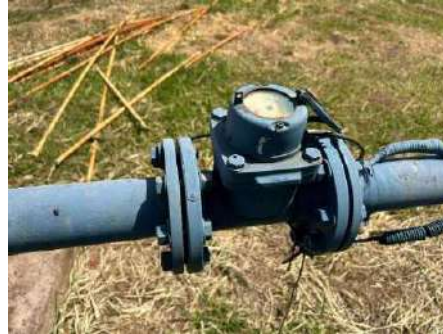
Figura 4-416 Vista do medidor de vazão do Poço Desativado Pedro Paschoal
