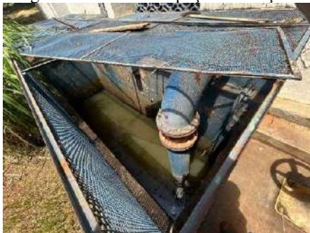
Figura 4-39 Vista dos poços de sucção
