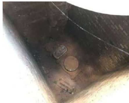
Figura 4-404 Vista tubulação de saída do Reservatório Centro
