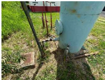
Figura 4-318 Vista da tubulação de saída para o FECCIB
