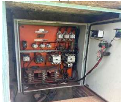
Figura 4-144 Vista interna do painel elétrico do poço Elizabeth
