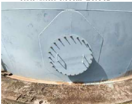
Figura 4-129 Tampa para limpeza do reservatório 1.000m 3 ETA 02
