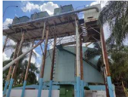
Figura 4-262 Vista dos tanques de resfriamento
