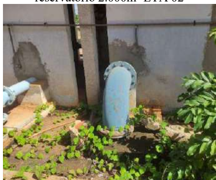
Figura 4-124 Tubulação de saída do reservatório 2.000m 3 ETA 02
