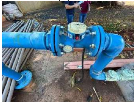
Figura 4-234 Vista lateral do medidor de vazão do poço Progresso
