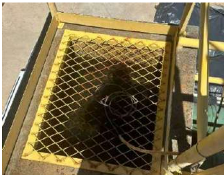
Figura 4-63 Vista aplicação de cloro na saída dos decantadores
