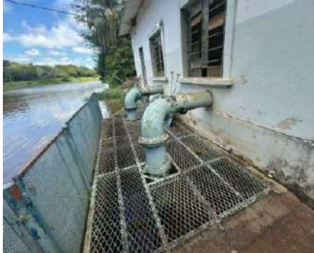
Figura 4-19 Vista dos poços de sucção
