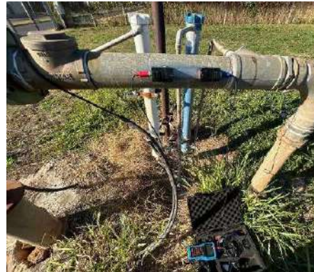
Figura 3-123. Medição de Vazão – Poço Elizabeth.
