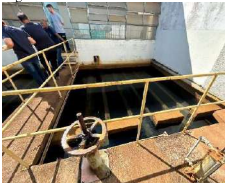
Figura 4-99 Vista do filtro 01 da ETA 02
