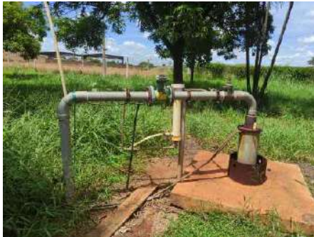
Figura 4-375 Vista frontal do poço Jordana Novo
