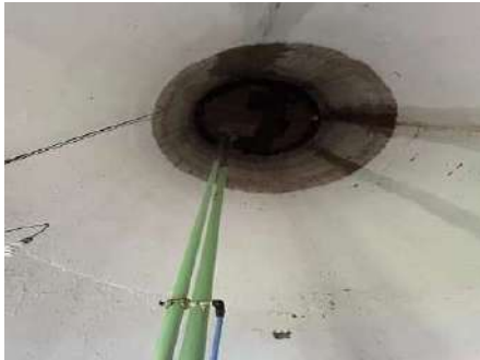
Figura 4-171 Vista do vazamento interno do reservatório de Andes
