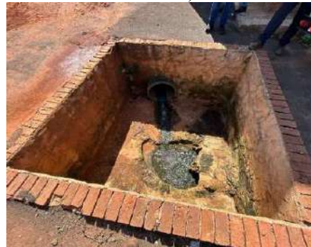
Figura 4-74 Vazamento proveniente da descarga dos filtros (vazamento 24 horas/dia)
