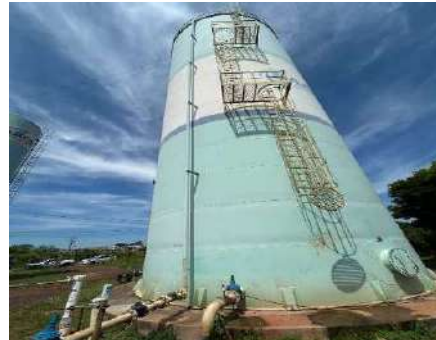
Figura 4-338 Vista da tubulação de entrada
