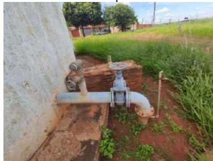
Figura 4-284 Vista da tubulação de saída do reservatório Tropical Alto/Baixo
