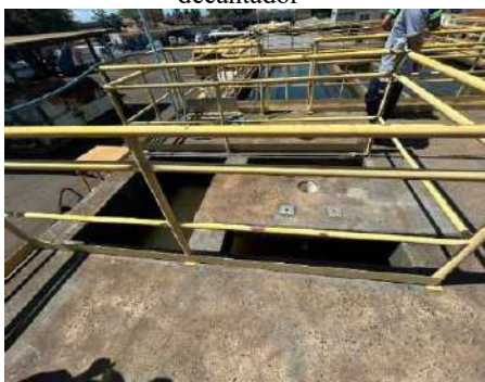
Figura 4-61 Vista floculador 4 sem operação, funcionando como um pré-decantador
