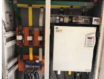
Figura 4-264 Vista interna do painel elétrico do Poço Sanderson e tanque de resfriamento
