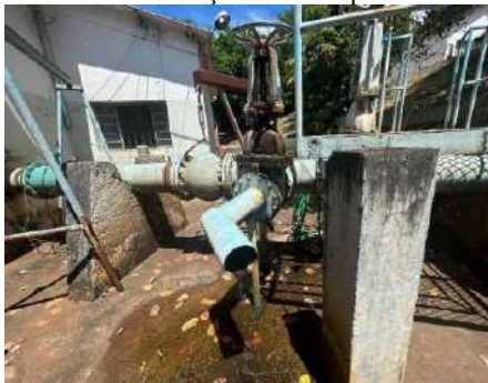
Figura 4-29. Vista vazamento no registro da tubulação de recalque
