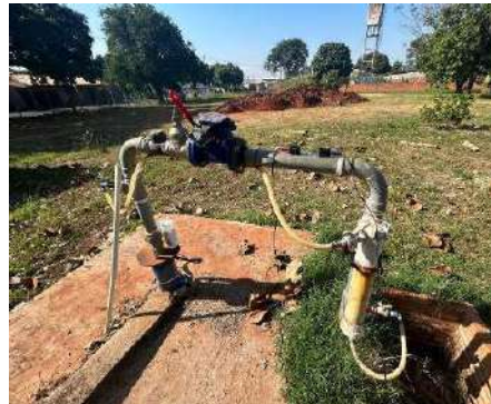
Figura 3-31. Medição de Vazão – Poço Novo ETA 02.
