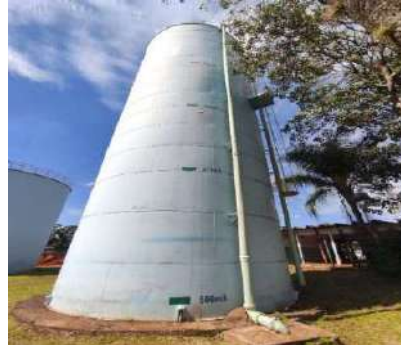
Figura 4-132 Medidas do reservatório São Carlos ETA 02
