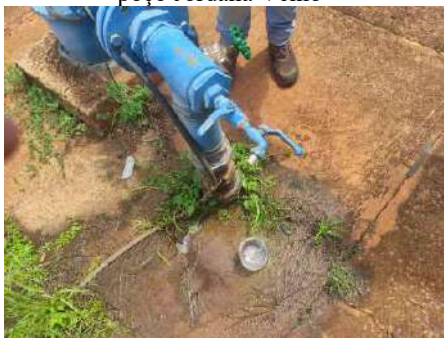
Figura 4-369 Vazamento na torneira do poço Jordana Velho
