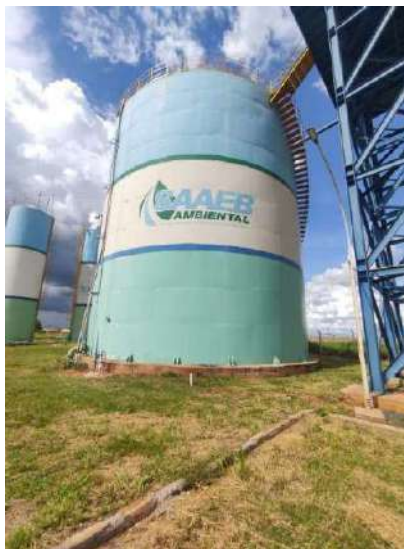
Figura 5-83. Reservatório Pedro Paschoal RPP-2000.
