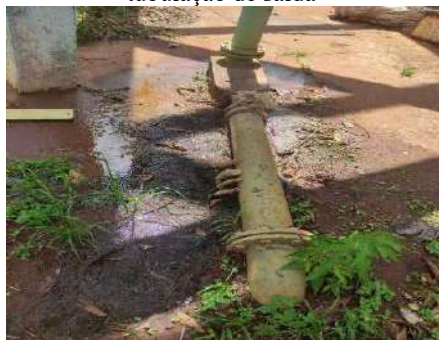
Figura 4-246 Vista do vazamento na tubulação de saída
