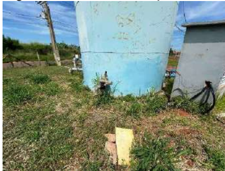
Figura 4-343 Vista da tubulação de saída
