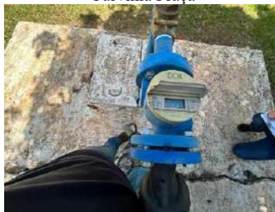
Figura 4-194 Medidor de vazão do poço Turvânia Praça
