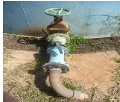
Figura 4-134 Tubulação de saída do reservatório São Carlos ETA 02
