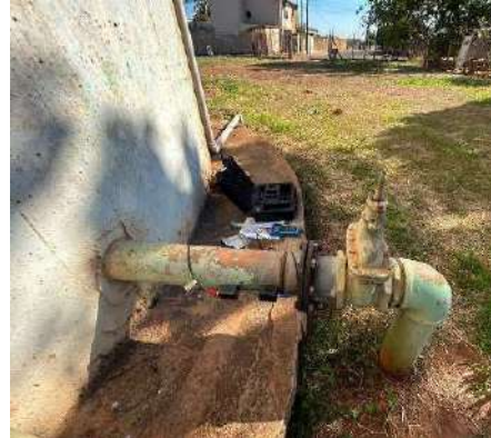
Figura 3-91. Medição de Vazão – Reservatório Tropical.
