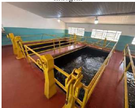
Figura 4-66 Vista dos tanques 01 e 02 de filtragem
