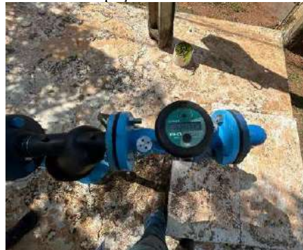
Figura 4-184 Vista do macro medidor do poço Turvina
