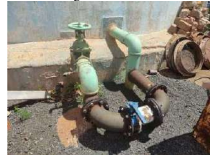
Figura 4-254 Tubulação de saída localizada na parte frontal do reservatório Progresso Alto/Baixo
