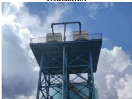
Figura 4-413 Vista dos tanques de resfriamento
