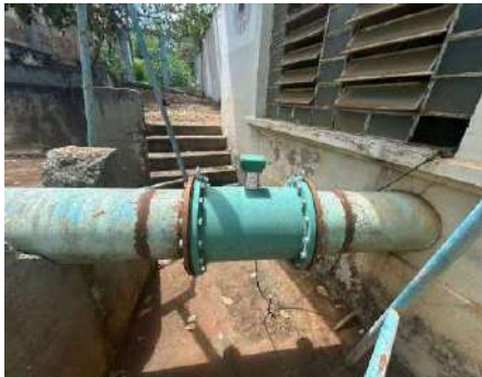
Figura 4-27 Vista macromedidor de vazão Ø350mm
