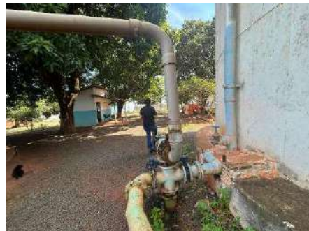
Figura 4-398 Tubulação de entrada do reservatório Centenário
