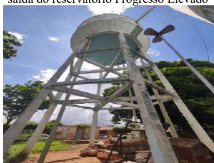
Figura 4-244 Tubulação de entrada e saída do reservatório Progresso Elevado
