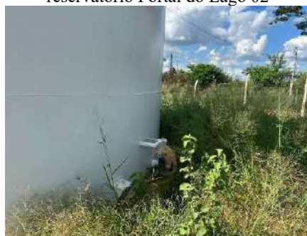
Figura 4-202 Tubulação de limpeza do reservatório Portal do Lago 02
