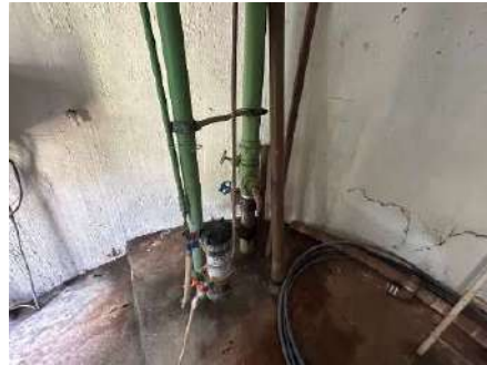
Figura 4-188 Vista da tubulação de entrada e saída do reservatório Turvânia
