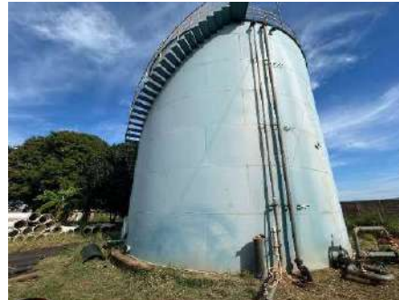
Figura 4-386 Tubulação de entrada do reservatório Jordana 1.000m 3
