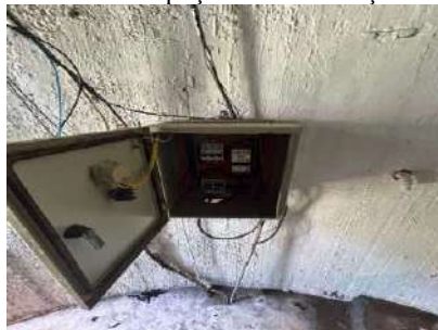
Figura 4-196 Vista do painel elétrico abeto do poço Turvânia Praça
