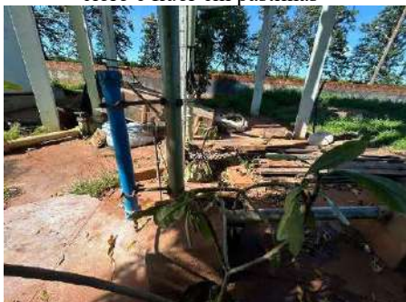
Figura 4-237 Tubulação de dosagem de cloro e flúor em pastilhas
