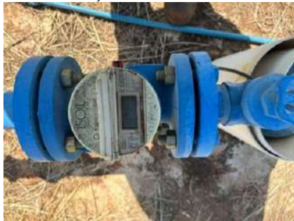
Figura 4-427. Vista medidor de vazão do Poço Pedro Paschoal
