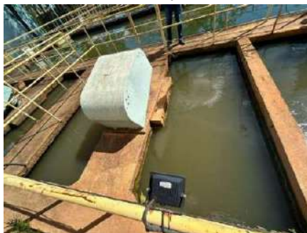
Figura 4-94 Vista do floculador 02 da ETA 02
