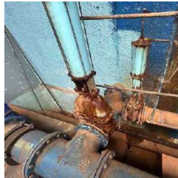
Figura 4-450. Registro de 200mm com vazamento
