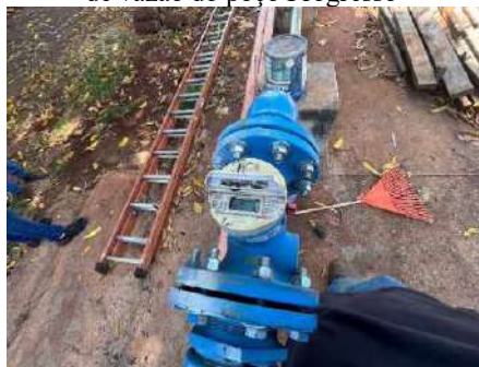
Figura 4-236 Vista elevada do medidor de vazão do poço Progresso
