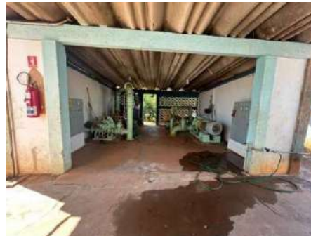
Figura 4-84 Vista da casa de bombas dos reservatório Caixa I ETA 01, reservatório Caixa II ETA 01 e reservatório Almojarifado ETA 01
