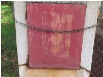
Figura 4-273. Vista local de abrigo e vazamento do hidrante
