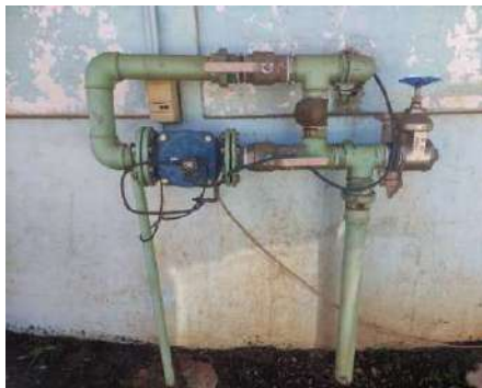
Figura 4-403. Vista tubulação de entrada do Reservatório Centro
