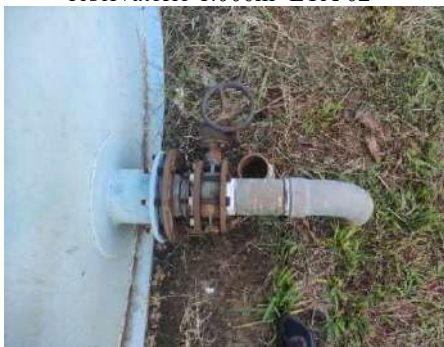
Figura 4-127 Tubulação de saída do reservatório 1.000m 3 ETA 02
