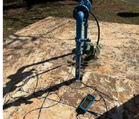
Figura 3-131. Medição de Vazão – Poço Turvinea.
