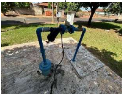
Figura 4-193 Vista do poço Turvânia Praça
