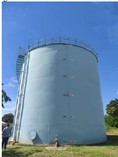
Figura 5-23. Reservatório 1.000m 3 ETAII.
