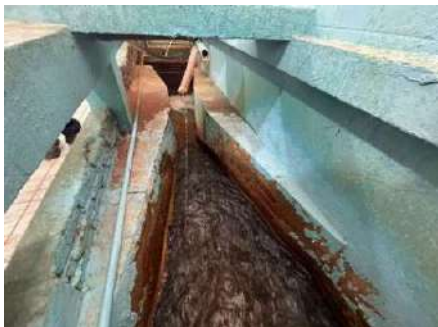
Figura 4-91 Chegada da água bruta vinda da CAP 02
