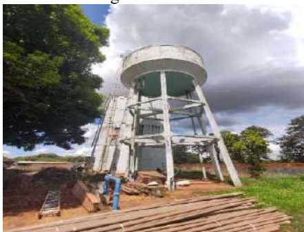
Figura 4-243 Vista do reservatório Progresso Elevado
