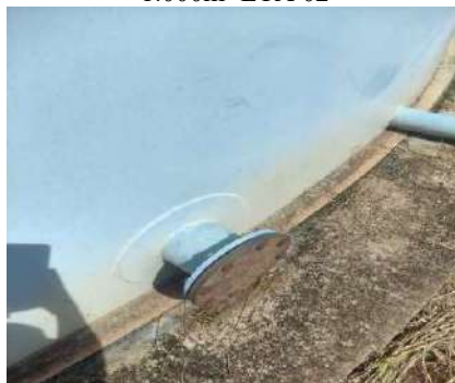
Figura 4-130 Flange cega do reservatório 1.000m 3 ETA 02
