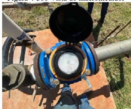
Figura 4-300 Vista do macromedidor
