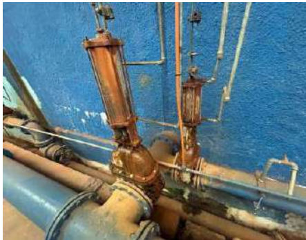
Figura 4-105 Registro de Ø300mm com vazamento
