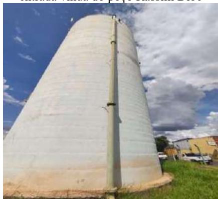
Figura 4-364 Vista da tubulação de entrada vinda do poço Rassim Dibe
