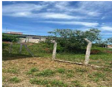
Figura 4-350 Vista do alambrado com buracos
