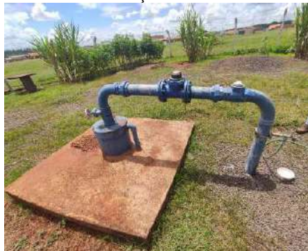
Figura 3-78. Vista do local de medição de vazão – Poço Sete Jardim.
