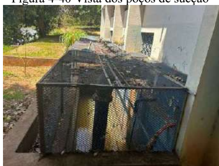
Figura 4-40 Vista dos poços de sucção
