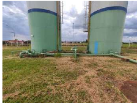
Figura 4-418 Vista das ligações entre os reservatórios
