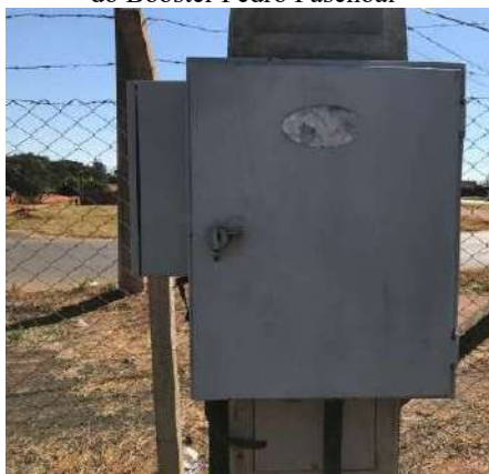
Figura 4-431 Vista externa painel elétrico do Booster Pedro Paschoal
