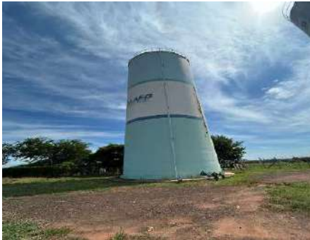
Figura 4-337 Vista do reservatório SetJardim
