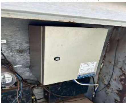
Figura 4-87 Vista do painel elétrico fechado do Pocinho ETA 01
