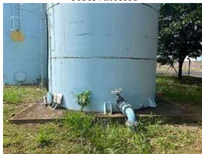
Figura 4-322 Tubulação de saída dos reservatórios
