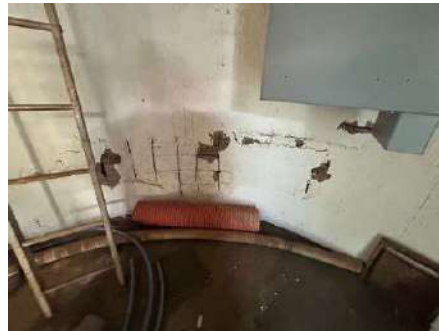
Figura 4-192 Vista da armadura à mostra dentro do reservatório Turvânia
