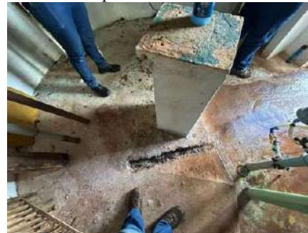
Figura 4-172 Erosão no concreto causado pelo vazamento
