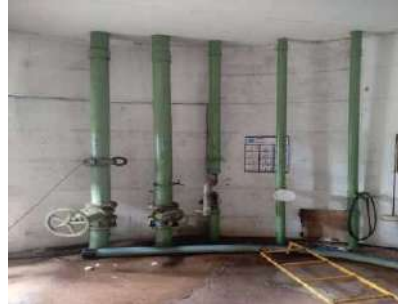
Figura 4-226 Tubulações de entrada e saída do reservatório Cláudia Alto/Baixo
