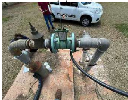
Figura 4-138 Vista do medidor de vazão sem o visor do poço ETA 02 Velho
