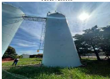
Figura 4-324 Tubulação vaso comunicante localizada acima no reservatório
