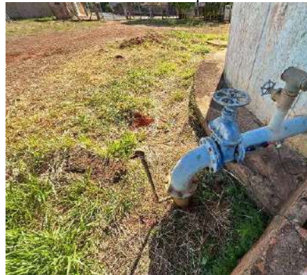
Figura 3-95. Medição de Vazão – Reservatório Tropical.
