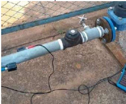
Figura 3-4. Transdutores fixados em tubulação metálica
