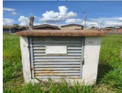
Figura 4-212 Vista do painel elétrico fechado do poço Primavera
