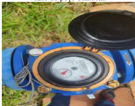
Figura 4-320 Vista do macromedidor de vazão do poço Santaella
