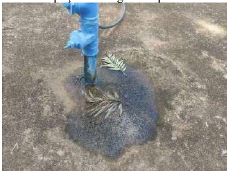
Figura 4-159 Vazamento na tubulação do poço Botafogo Campo
