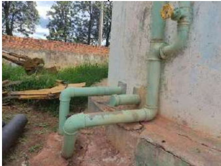
Figura 4-253 Tubulação de entrada das câmaras alta e baixa e tubulação de limpeza
