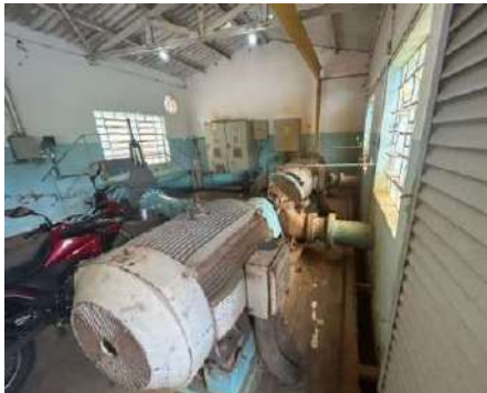
Figura 4-21 Vista dos conjuntos motor-bombas
