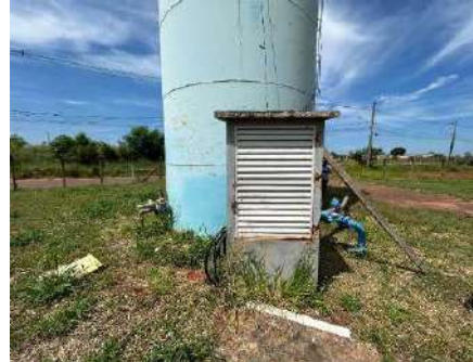
Figura 4-336 Painel elétrico do poço Souza Lima
