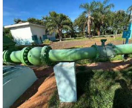
Figura 4-258 Vista da válvula de retenção e do medidor de vazão de Ø250mm
