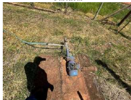
Figura 4-428 Vista do Booster Pedro Paschoal
