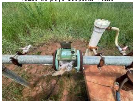
Figura 4-278 Vista do macromedidor de vazão do poço Tropical Velho
