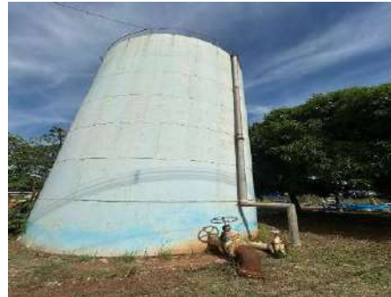
Figura 4-396 Tubulação de saída do reservatório Jordana 500m 3
