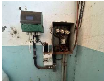
Figura 4-46 Vista display macromedidor de vazão
