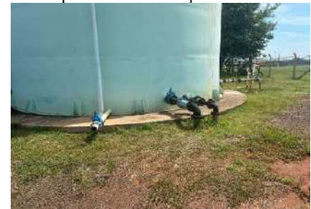
Figura 4-340 Vista da tubulação de limpeza e das tubulações de saída
