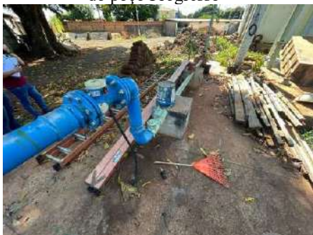
Figura 4-235 Continuação da tubulação do poço Progresso
