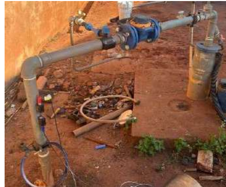
Figura 3-15. Medição de Vazão – Poço ETA 01.
