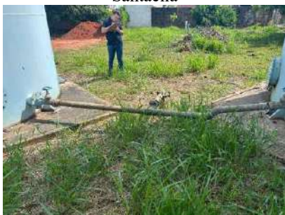
Figura 4-323 Tubulação vaso comunicante de entrada vinda do poço Santaella
