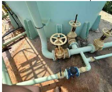
Figura 4-206 Vista tubulações de entrada e saída do reservatório Europa
