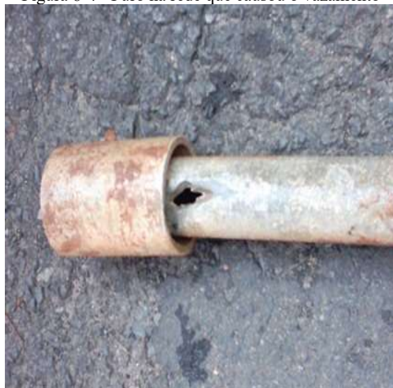
Figura 8-4 - Furo na rede que causou o vazamento
