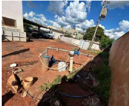
Figura 3-14. Vista do local de medição de vazão – Poço ETA 01.
