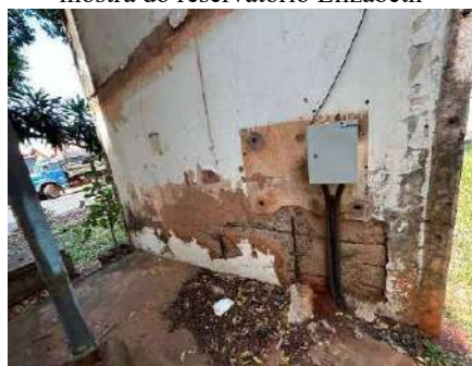
Figura 4-148 Vista das armaduras à mostra do reservatório Elizabeth
