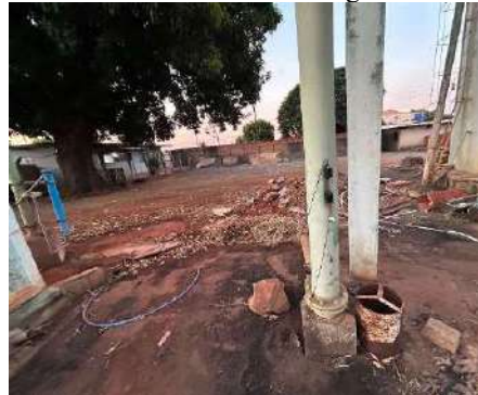
Figura 3-71. Medição de Vazão – Reservatório Elevado Progresso.
