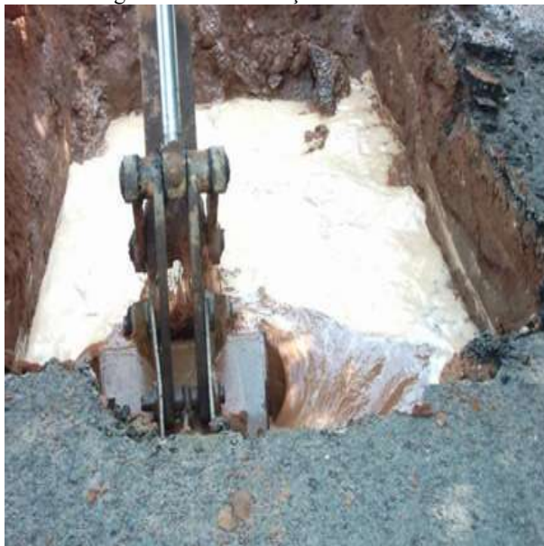
Figura 8-3 - Localização do vazamento
