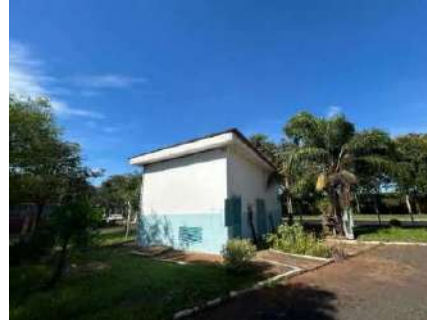
Figura 4-270 Vista casa de abrigo painel elétrico Poção Sanderson e tanques de resfriamento
