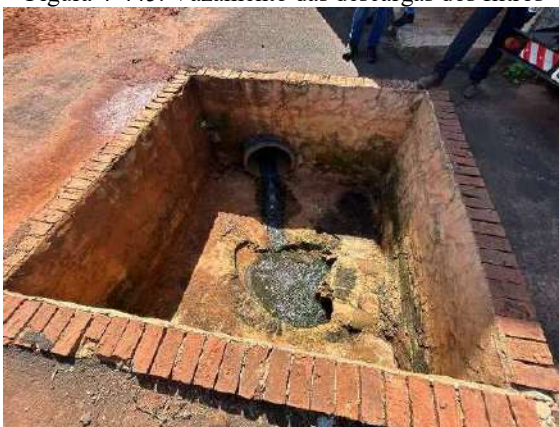
Figura 4-445. Vazamento das descargas dos filtros
