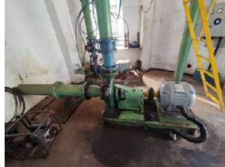
Figura 4-78 Conjuntos motor-bombas para alimentação do reservatório Torre ETA 01
