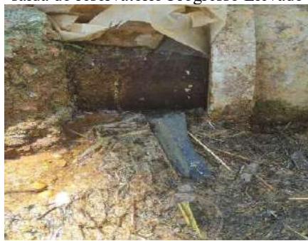
Figura 4-248 Grande vazamento localizado no Gibault da tubulação de saída do reservatório Progresso Elevado
