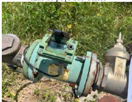
Figura 4-306 Vista do macromedidor de vazão do poço São Carlos
