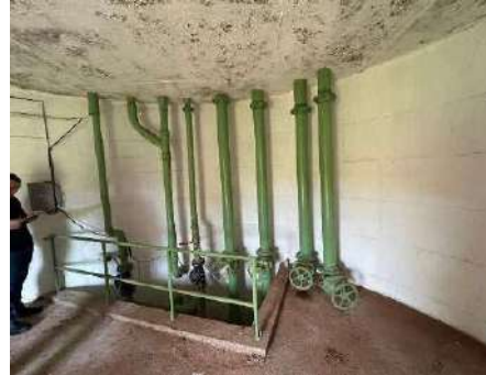
Figura 4-358 Vista das tubulações de entrada, saída e limpeza
