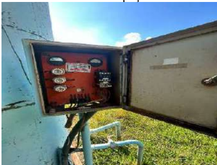
Figura 4-178 Vista do painel elétrico aberto da bomba do poço de Areias
