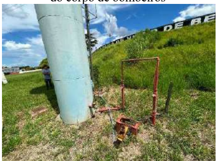
Figura 4-317 Vista da tubulação de saída do corpo de bombeiros
