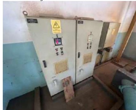
Figura 4-22 Vista painéis elétricos dos conjuntos motor-bombas
