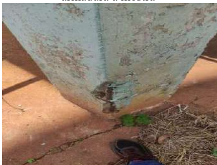
Figura 4-249 Viga de sustentação com armadura à mostra
