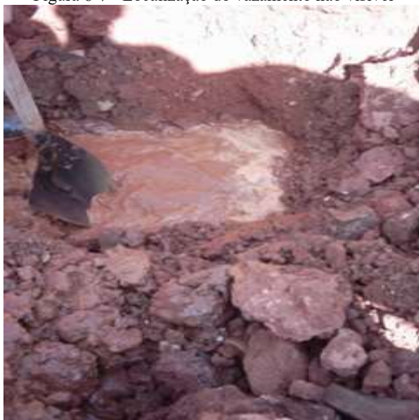
Figura 8-7 - Localização do vazamento não visível
