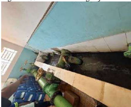
Figura 4-67 Vista saída da água já filtrada
