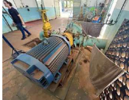
Figura 4-42 Vista dos conjuntos motor-bombas
