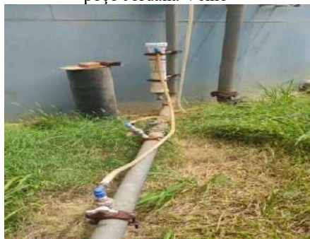
Figura 4-370 Sistema de tratamento do poço Jordana Velho
