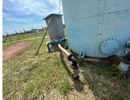
Figura 4-342 Tubulação de entrada do reservatório Souza Lima
