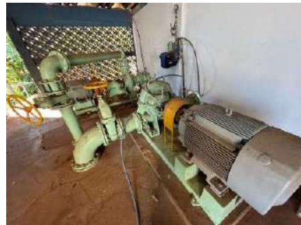
Figura 4-82 Conjuntos motor-bombas B01 e B02
