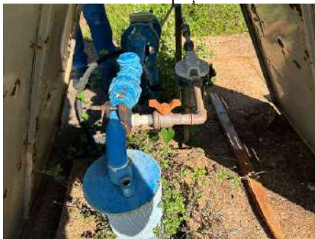
Figura 4-177 Vista do sistema aplicação de cloro e flúor do poço de Areias
