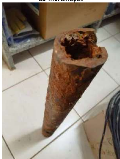
Figura 11-1. Tubulação de Ferro Fundido DN 50mm apresentando grau avançado de incrustação
