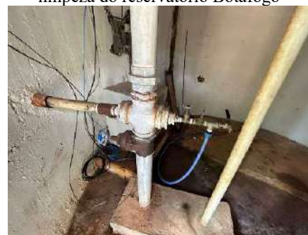
Figura 4-156 Tubulação de Saída e de limpeza do reservatório Botafogo
