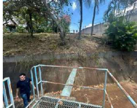
Figura 4-26 Vista tubulação de recalque dos conjuntos motor-bombas
