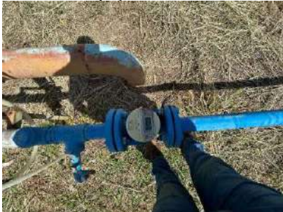
Figura 4-211 Vista do medidor de vazão do poço Primavera
