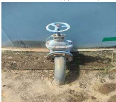
Figura 4-128 Tubulação de limpeza do reservatório 1.000m 3 ETA 02
