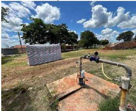
Figura 3-30. Vista do local de medição de vazão – Poço Novo ETA 02.
