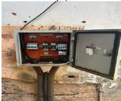
Figura 4-143 Vista frontal do painel elétrico do poço Elizabeth
