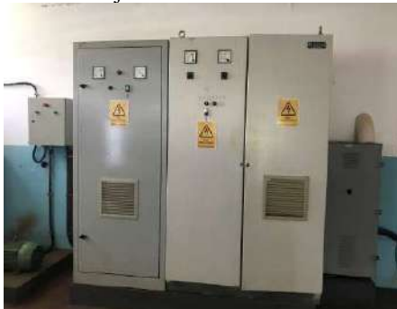
Figura 4-43 Vista painéis elétricos dos conjuntos motor-bombas
