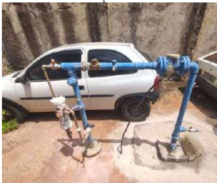
Figura 3-62. Vista do local de medição de vazão – Poço Boa Vista.
