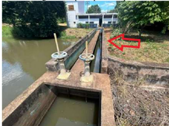
Figura 4-443. Falta de guarda corpo na passarela para acesso as comportas
