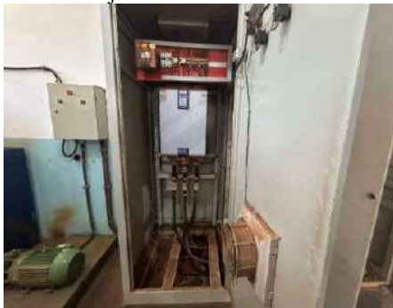
Figura 4-45 Vista painel elétrico do conjunto motor-bomba 02
