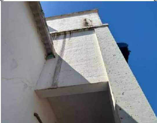
Figura 4-447. Vazamento no reservatório de retrolavagem
