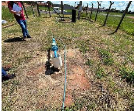
Figura 4-425 Vista geral do Poço e Booster Pedro Paschoal
