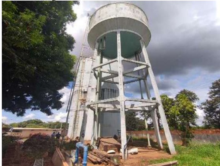
Figura 5-102. Reservatório elevado RPRE.
