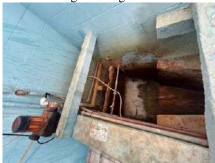
Figura 4-92 Aplicação de PAC na chegada de água bruta
