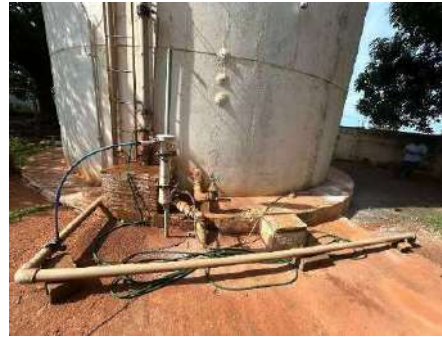
Figura 4-388 Tubulação de entrada do reservatório Jordana Alto/Baixo
