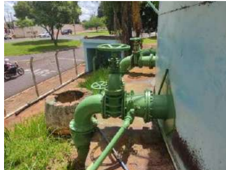
Figura 4-266 Vista das tubulações de saída do Reservatório Sanderson
