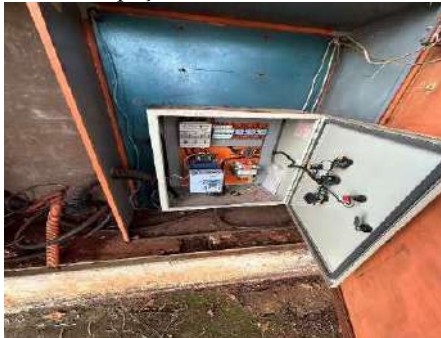
Figura 4-373 Painel elétrico aberto do poço Jordana Velho
