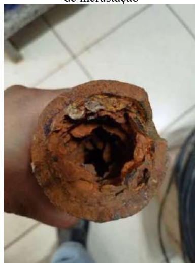
Figura 11-2. Tubulação de Ferro Fundido DN 50mm apresentando grau avançado de incrustação
