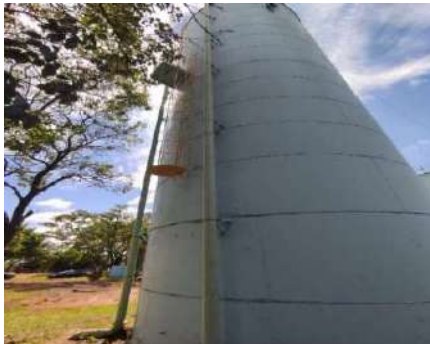
Figura 4-133 Tubulação de chegada do reservatório São Carlos ETA 02
