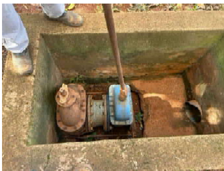
Figura 4-391 Tubulação de limpeza do reservatório Jordana Alto/Baixo
