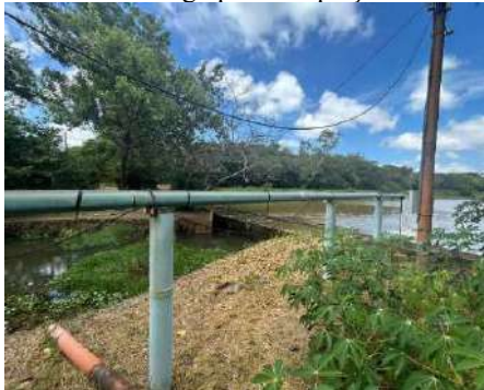
Figura 4-17. Vista tubulação de recalque do córrego para a captação
