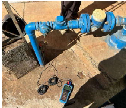
Figura 3-139. Medição de Vazão – Poço Andes.
