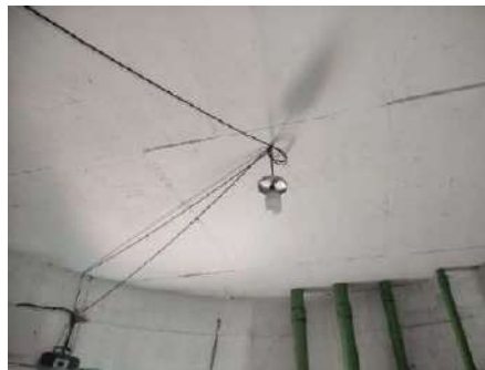
Figura 4-232 Vista da iluminação interna do reservatório Cláudia Alto/Baixo com defeito
