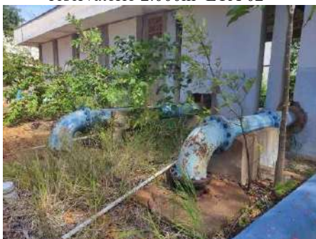
Figura 4-121 Tubulações de entrada do reservatório 2.000m 3 ETA 02
