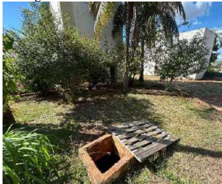
Figura 4-112 Local do vazamento
