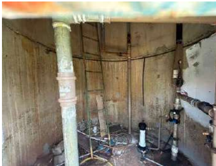
Figura 4-295 Vista das tubulações de entrada e saída do reservatório Julia
