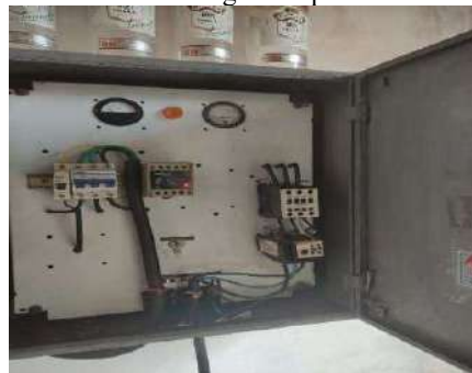
Figura 4-160 Painel elétrico do poço Botafogo Campo
