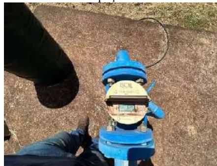
Figura 4-312 Vista do Macromedidor de vazão do poço FECCIB
