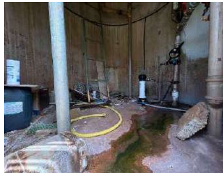
Figura 4-296 Vista de um vazamento interno do reservatório Julia
