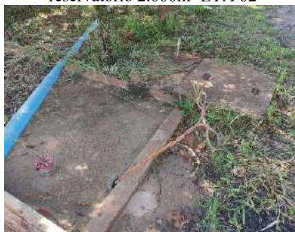
Figura 4-122 Tubulação de entrada para o reservatório 2.000m 3 ETA 02
