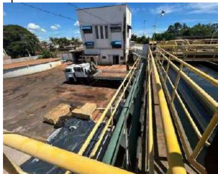
Figura 4-64 Vista da tubulação de água percorre dos decantadores até os filtros
