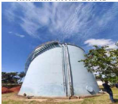
Figura 4-126 Tubulação de chegada do reservatório 1.000m 3 ETA 02
