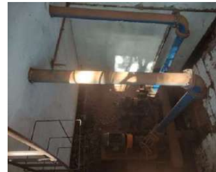
Figura 4-118 Vista do conjunto motor-bombas B06 e B07
