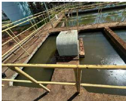
Figura 4-96 Vista do floculador 04 da ETA 02
