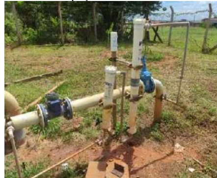
Figura 4-332 Sistema de tratamento do poço SetJardim
