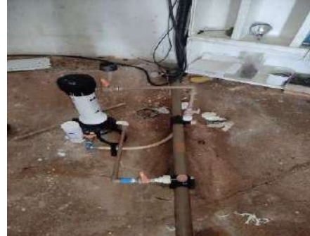
Figura 4-228 Tubulação de dosagem de cloro e flúor por pastilha
