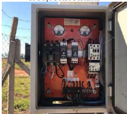
Figura 4-430 Vista interna painel elétrico do Poço Pedro Paschoal
