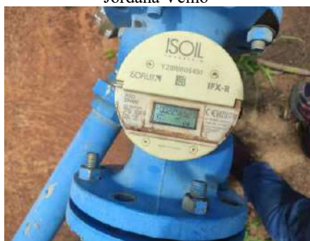
Figura 4-368 Macromedidor do poço Jordana Velho
