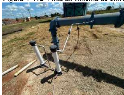
Figura 4-412 Vista do sistema de cloro
