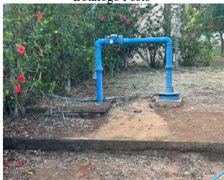
Figura 4-149 Vista frontal do poço Botafogo Posto
