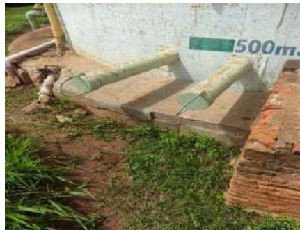
Figura 4-286 Vista da tubulação de limpeza do reservatório Tropical Alto/Baixo
