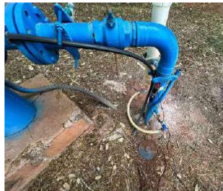
Figura 3-119. Medição de Vazão – Poço Elizabeth.
