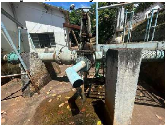
Figura 4-439. Vista do registro com vazamento
