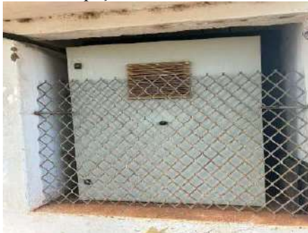
Figura 4-379 Vista do painel elétrico do poço Jordana Novo
