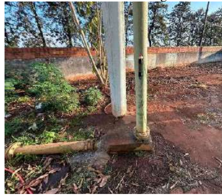
Figura 3-67. Medição de Vazão – Reservatório Elevado Progresso.
