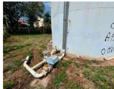
Figura 4-346 Vista da tubulação de entrada
