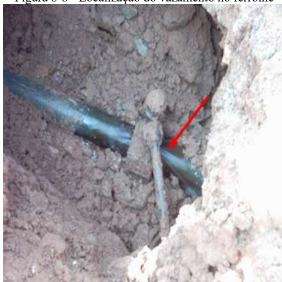
Figura 8-8 - Localização do vazamento no ferrolhe
