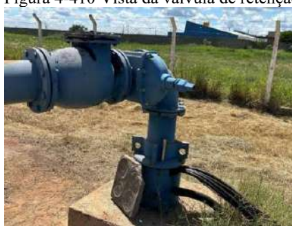
Figura 4-410 Vista da válvula de retenção
