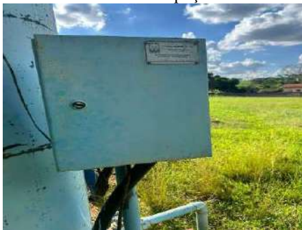
Figura 4-179 Vista do painel elétrico fechado da bomba do poço de Areias
