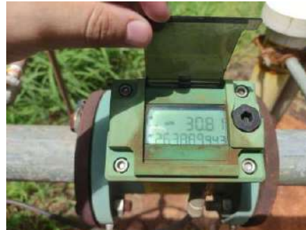
Figura 4-376 Macromedidor do poço Jordana Novo
