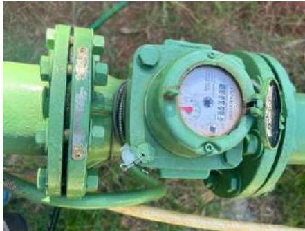
Figura 4-261 Vista do medidor de vazão de Ø100mm
