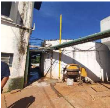
Figura 3-6. Vista do local de medição de vazão - Chegada da água bruta na ETA 01.
