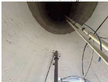
Figura 4-158 Tubulação de entrada do reservatório Botafogo
