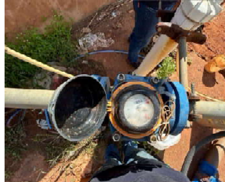
Figura 4-86 Vista do macromedidor
