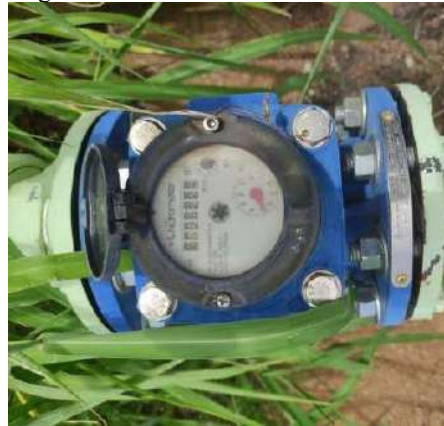
Figura 4-204 Vista do medidor de vazão
