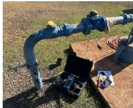
Figura 3-79. Medição de Vazão – Poço Sete Jardim.
