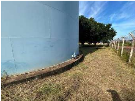
Figura 4-385 Tubulação de limpeza do reservatório Jordana 1.000m 3
