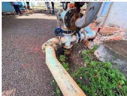
Figura 4-390 Tubulação de saída do reservatório Jordana Alto/Baixo
