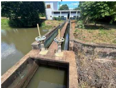
Figura 4-37 Comportas do canal da água bruta captada
