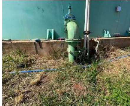
Figura 3-43. Medição de Vazão – Reservatório 2.000m 3 Pedro Paschoal.
