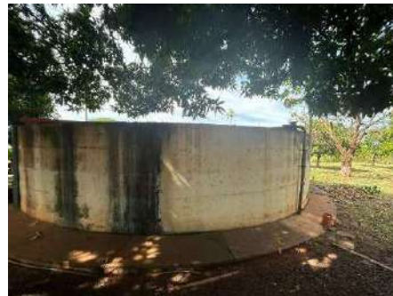
Figura 4-400 Manchas de água no reservatório Centenário
