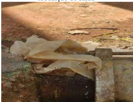
Figura 4-247 Vista de um plástico tampando o vazamento no Gibault da tubulação de saída
