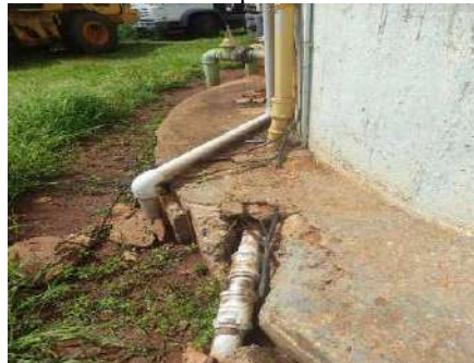
Figura 4-282 Tubulações de entrada do reservatório Tropical Alto/Baixo
