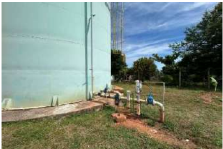
Figura 4-339 Vista da tubulação de entrada do reservatório SetJardim
