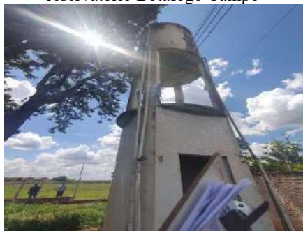
Figura 4-164 Tubulação de entrada do reservatório Botafogo Campo
