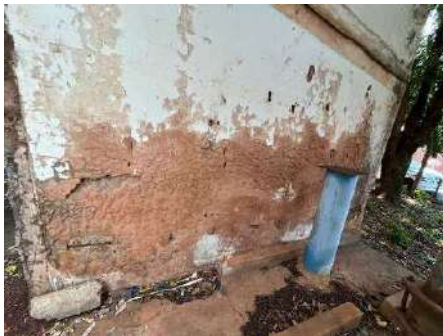
Figura 4-147 Vista das paredes internas do reservatório Elizabeth deteriorando
