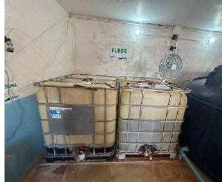
Figura 4-72 Armazenamento de flúor
