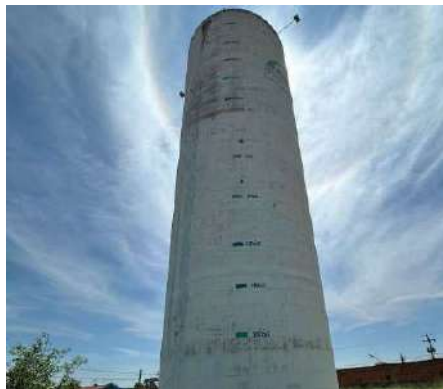
Figura 3-54. Vista do local de medição de vazão – Reservatório Alto Boa Vista.
