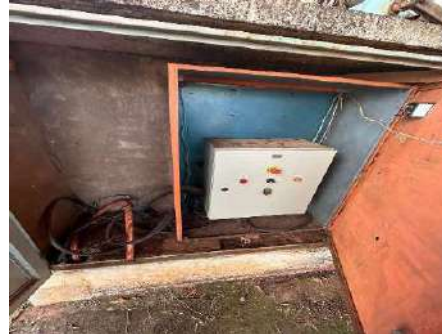
Figura 4-372 Painel elétrico do poço Jordana Velho
