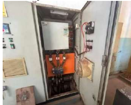
Figura 4-24 Vista painel elétrico do conjunto motor-bomba 02
