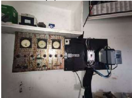
Figura 4-229 Vista do painel elétrico do poço Cláudia
